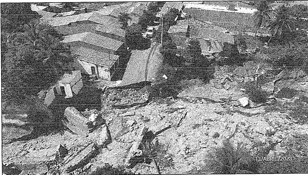
Figura 9 – Passagem molhada destruída na Rua João Pires.
