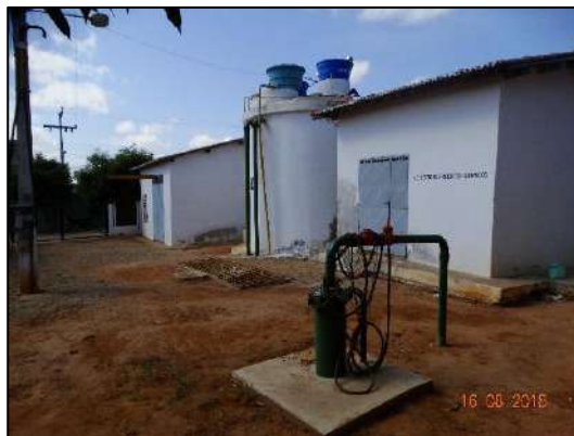
Imagem 1 – Poço tubular destinado ao abastecimento no município de Porteiras
